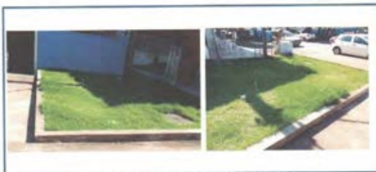
Fig 04. Sistema de tratamento de esgoto.
