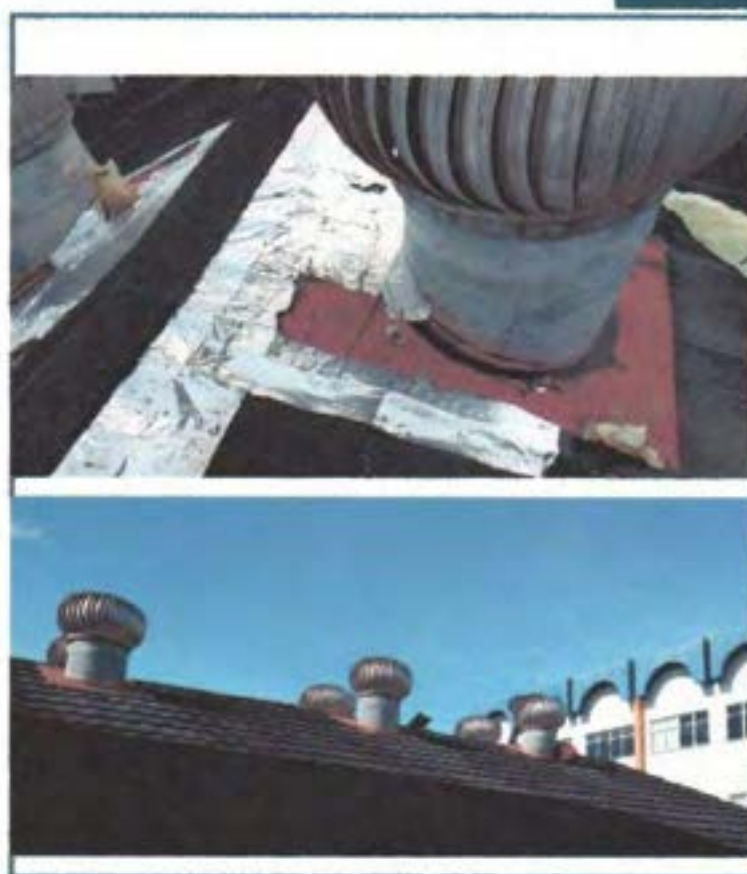
Fig 03. Retração de Exaustores;
